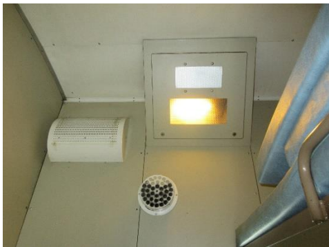
Kuvassa tulo- ja poistoilman aukot/ritilät sekä sellin valaistus. Ilmanvaihtoaukot olivat likaiset.
