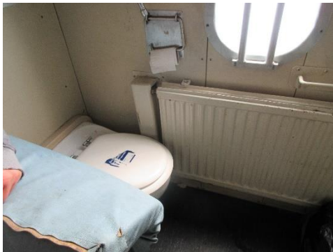
Kuvassa patjaa käännetty siten, että wc-istuin tulee esiin. Patjan päällys on rikki.
