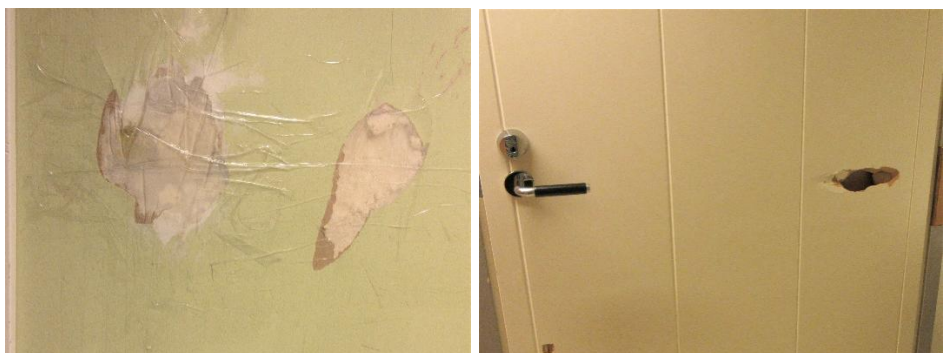
Kuvat 4 ja 5. Vaurioitunut seinä ja ovi
