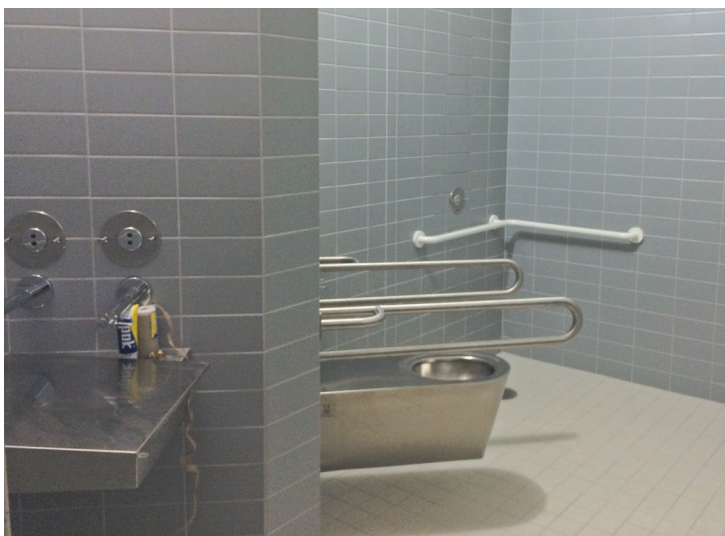
Vid polisfängelset i Böle, polis-inrättningen i Helsingfors, gjordes en oanmäld inspektion 22.9 med avsikt att utreda hur den pågående renoveringen påverkade förhållandena i polisfängelset. – På bilden ses toaletten i en ny cell för personer med funktionshinder.
